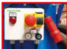
Quadro elettrico trifase
